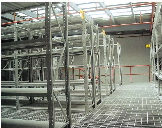
(实景) 日产汽车配送中心,使用大昌阁楼式货架。 Dachang mezzanine storage built in Nissan motor's 4S shop.
